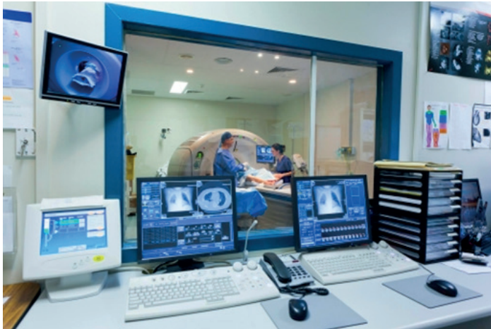
Imagen 2. Instalaciones en la sala de Resonancia Magnética.
